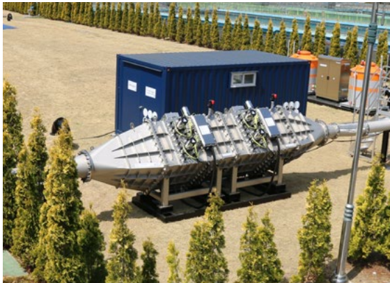
漆西淨水厂设备
