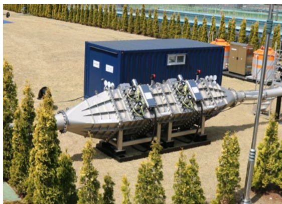
漆西淨水厂设备
