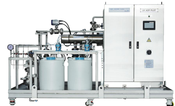
Pilot skid UV AOP 시험 설비
